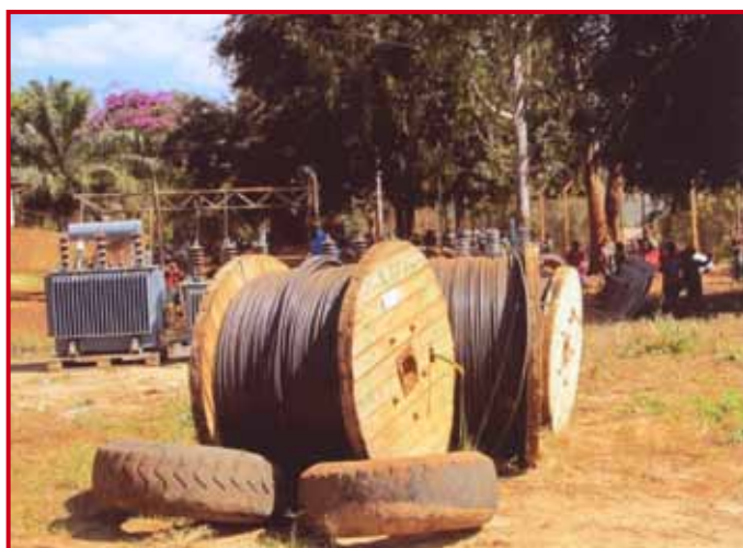
Cavi e trasformatori per la linea elettrica
